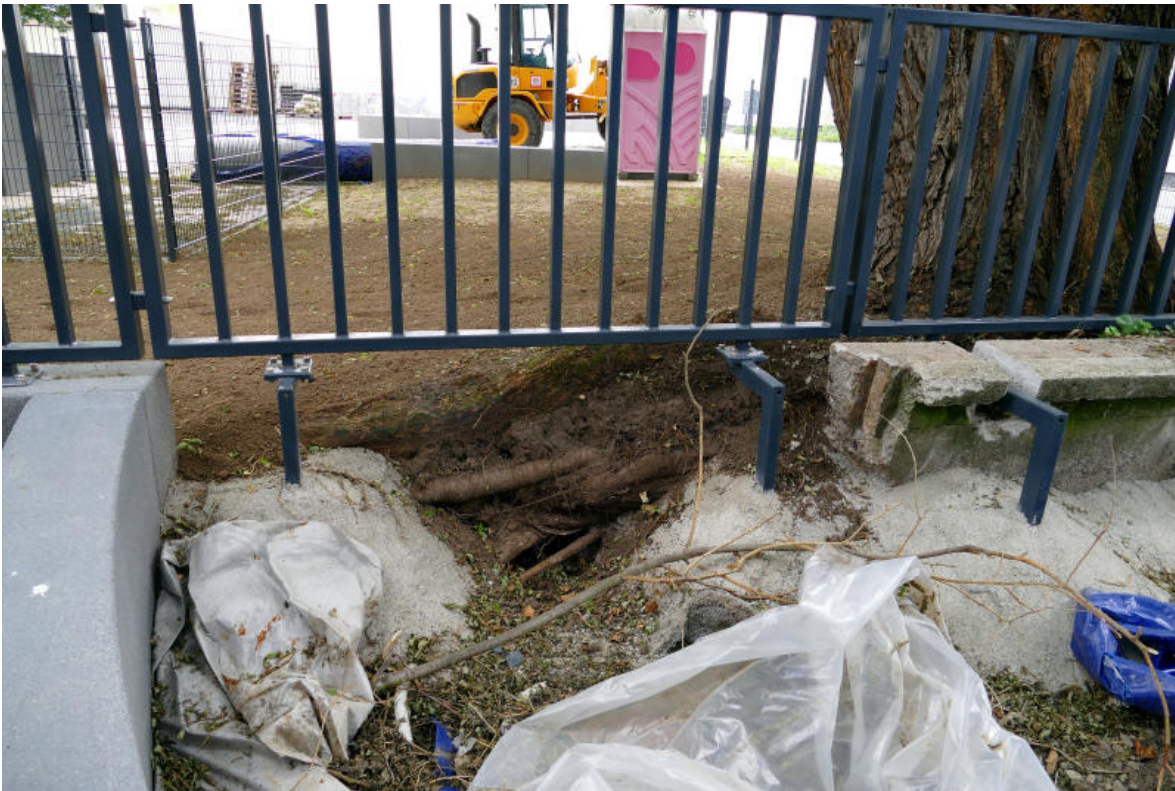
Abb. Wurzelschaden durch Bauarbeiten / Foto: Marko Wäldchen „Schön“ zu sehen, wie flach die Wurzeln unter der Erde verlaufen können.
