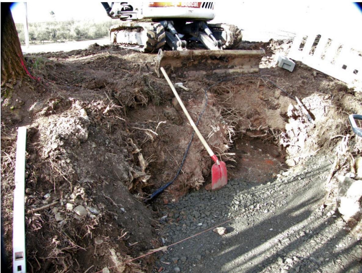
Abb. Wurzelschaden durch Bauarbeiten / Foto: Marko Wäldchen
